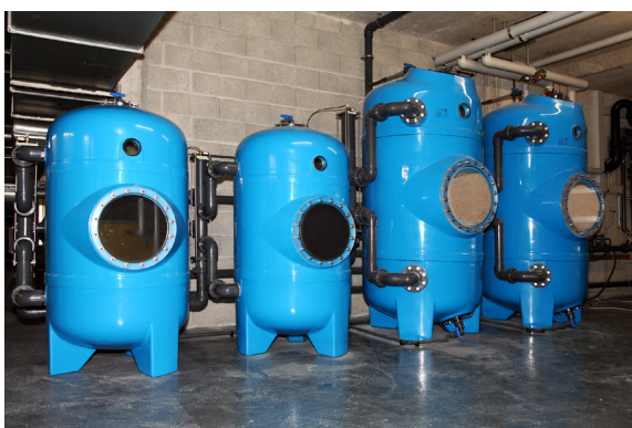
Filtres à charbon (gauche) et filtres à sable (droite)
